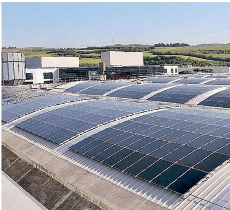
SOLE L'impianto produce 1.360.000 KWH. A destra Alberto Scavolini
