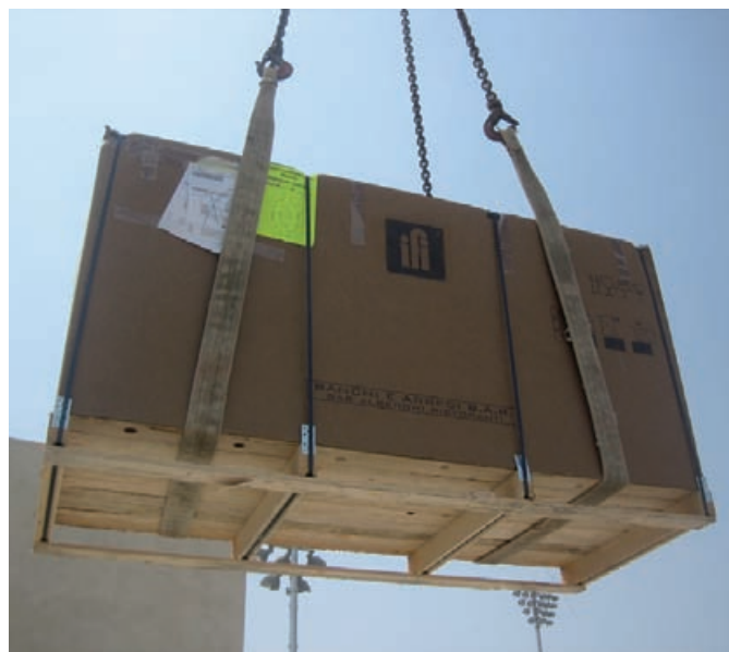
NELLE IMMAGINI: LE FASI DI MOVIMENTAZIONE DEI BANCALI ALL'INTERNO DEL MEDIA CENTER ; I BANCALI VENGONO CARICATI SULLA TERRAZZA DEL CRASH CLUB ; I BANCALI PER LE INSTALLAZIONI, IN ATTESA DI ESSERE TRASPORTATI AL SECONDO PIANO E SULLA TERRAZZA.
